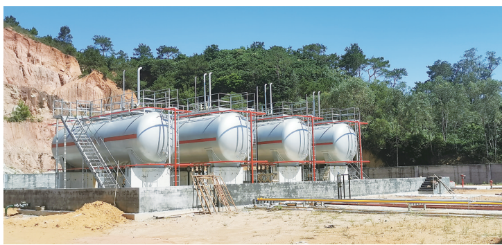
长坡液化石油气储配(充装)站。
