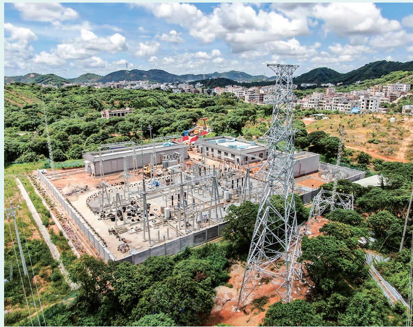
竣工投产的110千伏根子变电站。
