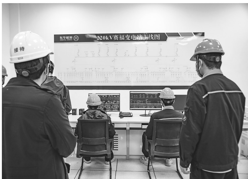
技术人员在检查调试配电情况。 本报记者 丘立贺 摄
