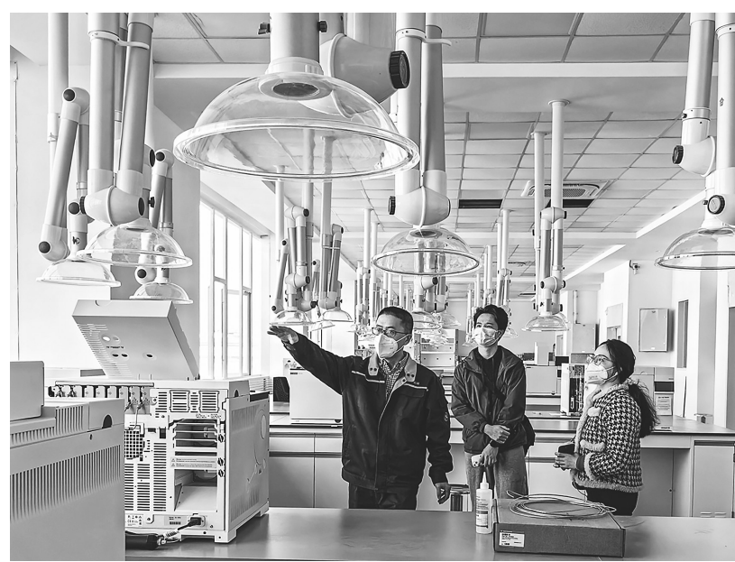
化验室的设备仪器已经进入安装调试。图为技术人员在为记者介绍化验室的调试情况。 本报记者 丘立贺 摄
