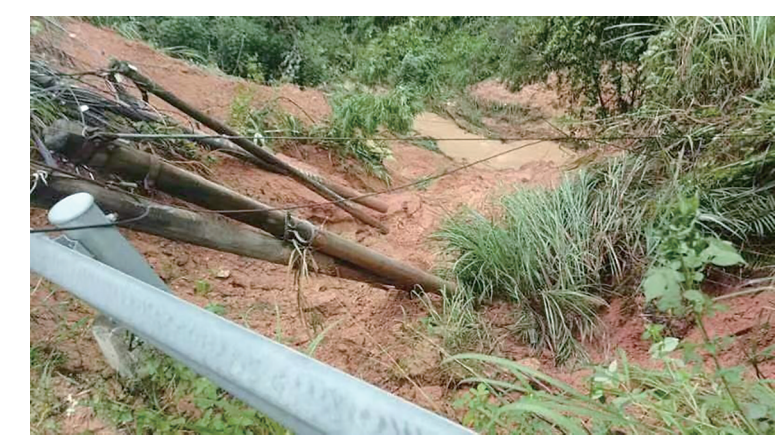
新宝大麻沙通信线路受灾现场。通讯员 杨勋 钟华中 宁清绪 摄
