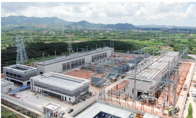
▲500千伏电白变电站航拍图。
