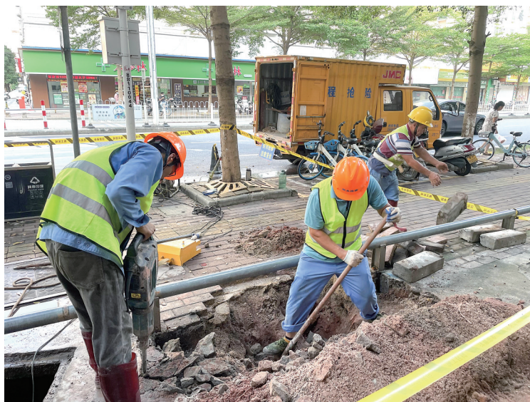
10月1日，中秋国庆假期，市区城南路一水管爆裂漏水，粤海水务公司抢修人员迅速赶到现场，经全力抢修，下午恢复正常供水。
