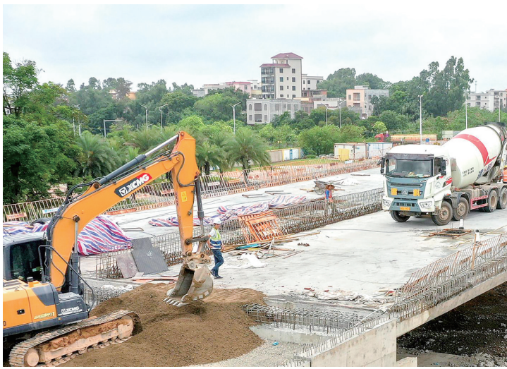
海洋大道立交项目施工中。茂名日报社全媒体记者 岑稳摄
