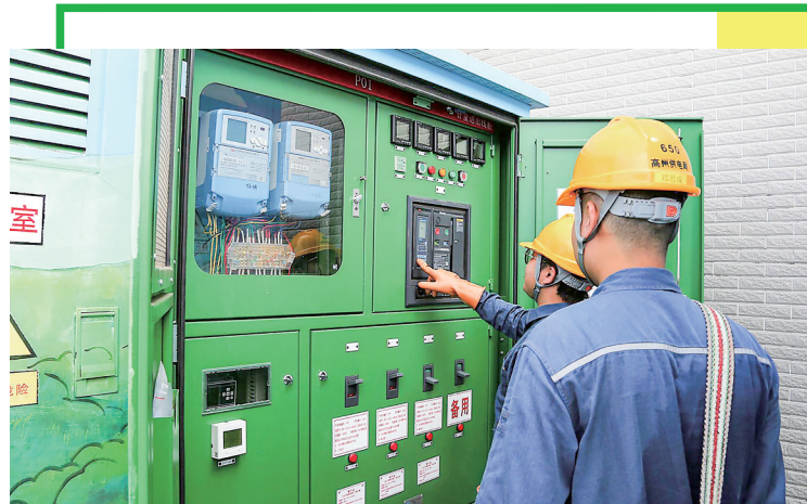
根子供电所工作人员检查10KV柏桥公用箱变运行情况。
