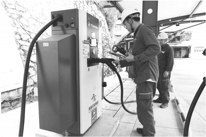
电白供电局工作人员对充电桩的连接点进行检查。
