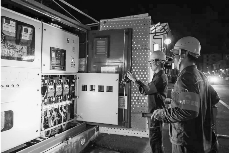
10月1日,供电所党员突击队在电白观珠沙垌村进行夜间特巡及测温。通讯员 黄琦之 摄
