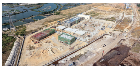
茂名丙烯酸产业园项目施工现场。茂名日报社全媒体记者 刘付思明 摄
