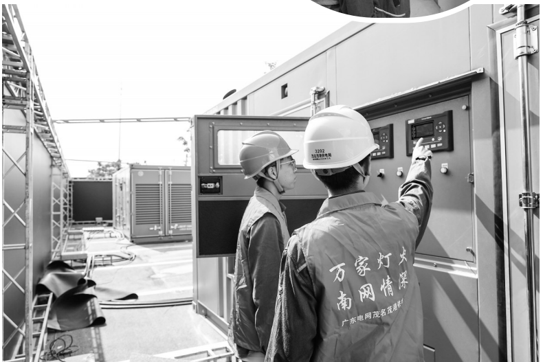
供电人员在茂名奥体中心体育馆内外开展电力设备检查工作。 通讯员 梁宇宏 摄
