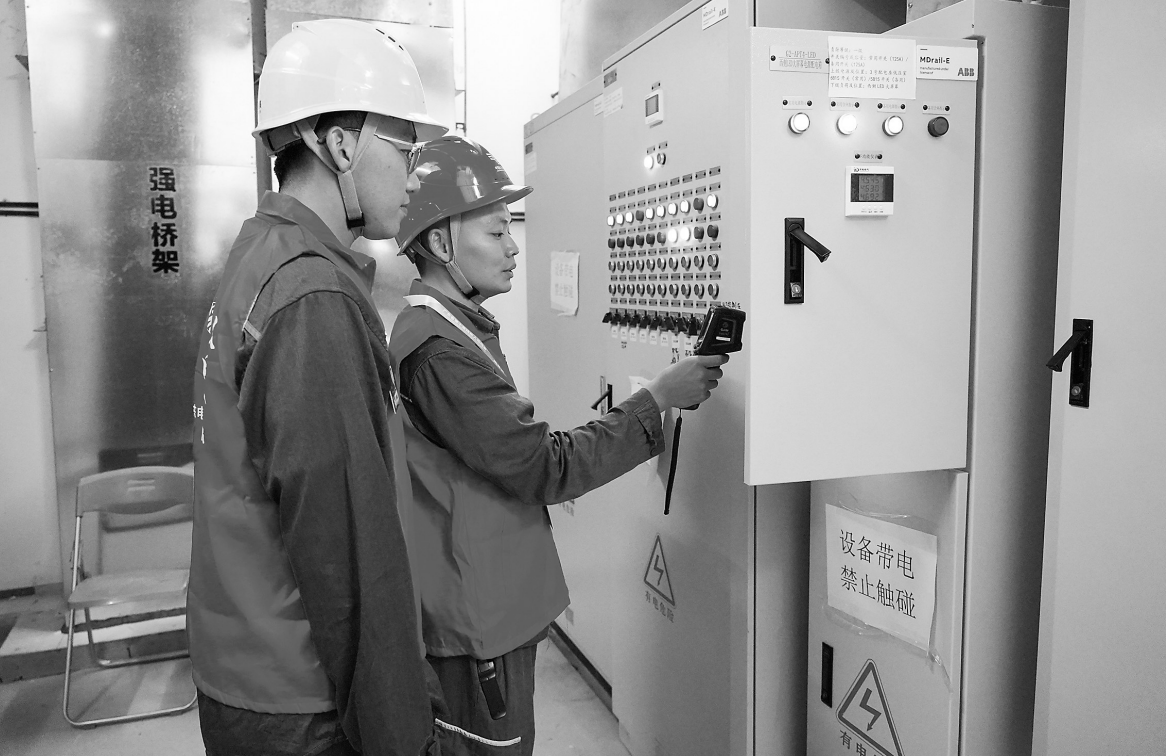
省残运会闭幕式当天,茂名茂港供电局保电人员对场馆供电设备进行红外测温。 通讯员 梁宇宏 摄
