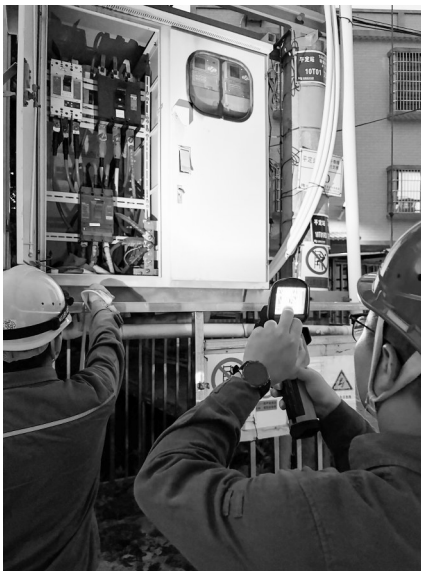
工作人员对配电设备红外测温,排查发热隐患,守护双节供电。 通讯员 邱志涌 摄
