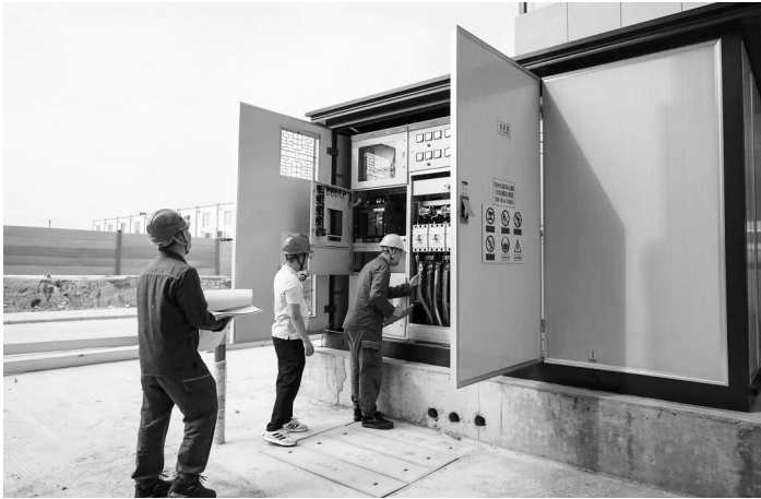
信宜供电局运维人员对万洋众创城B区公用箱变进行投运前验收,严把设备投运质量关口。
